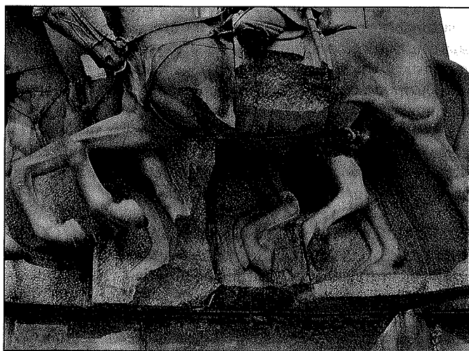
Figura 3 - Pedestal em granito da estátua do Duque de Caxias. Pça Duque de Caxias. A sela e as pernas do cavalo estão quebradas.
